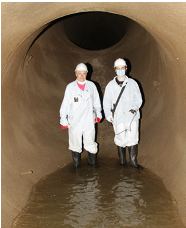
Рис. 5. Відновлення підземного водоводу циркуляційної води на Південно-Українській АЕС, зліва доцент В.О. Бондар (2020 р.) [Архів кафедри]
